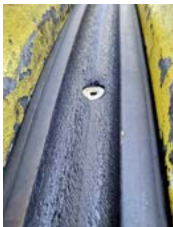
Abbildung 2: zurückstehende Kontaktbolzen in der Umlenkscheibe einer Umlaufbahn
