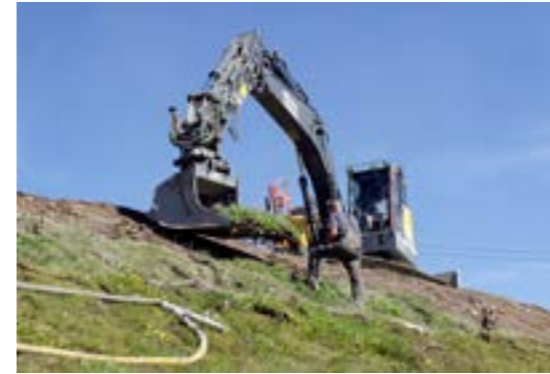
Der Wasen (Grasziegel) wird fein säuberlich abgetragen und kurze Zeit später wieder am Dammbau eingebaut.
