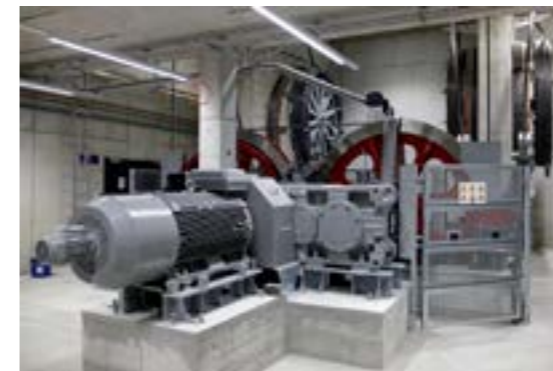
Die Antriebstechnik ist in der Bergstation Furi untergebracht.
