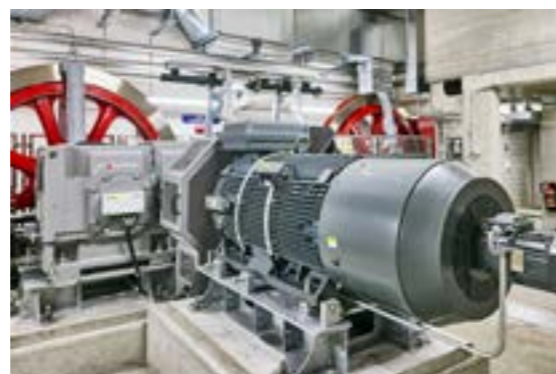
Im ehemaligen Maschinenraum in der Talstation wurde die neue Antriebstechnik untergebracht.
