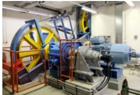
Der Antriebsmotor (ABB) sowie das Getriebe wurden während des Umbaus revidiert. Die Revision des Getriebes wurde von Gebrüder Meier durchgeführt.
