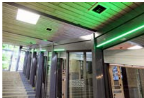
In der Decke über den Einstiegstüren sind 3D-Sensoren installiert, welche die zugestiegenen Passagiere zählen.
